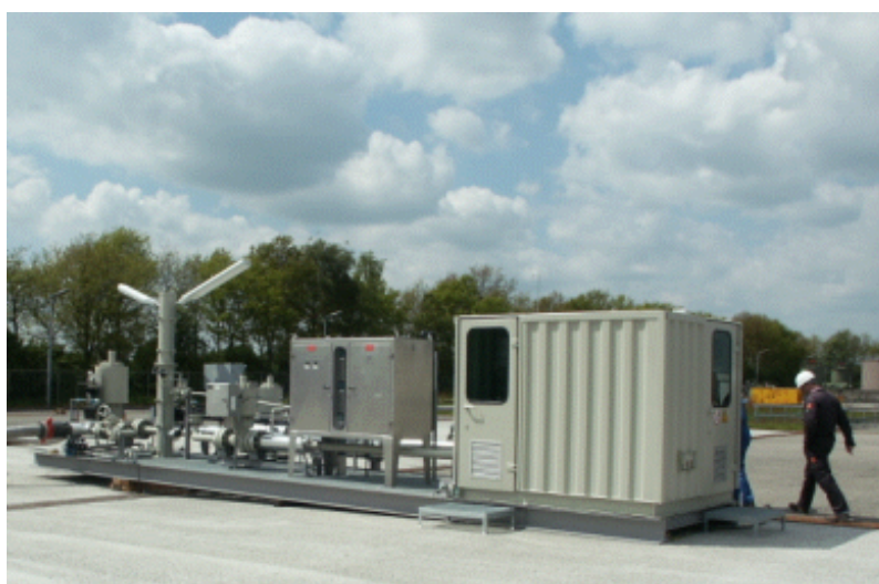
Figuur 2.15: Foto van een compacte productieunit (per put). Deze unit zal voor de winning van het gas worden toegepast en is op schaal geprojecteerd in bovenstaande locatie plattegronden.
